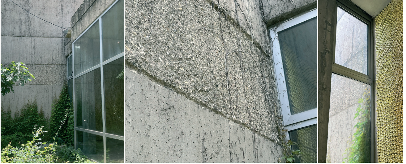
Resim 9. 20.Ekim.1962 tarihinde F Blok +375 kotu döşeme kasetlerinin uygulamasında meydana gelen soruna dair günümüzde yapıda okunan iz (F. Diri Akyıldız, 2024)
