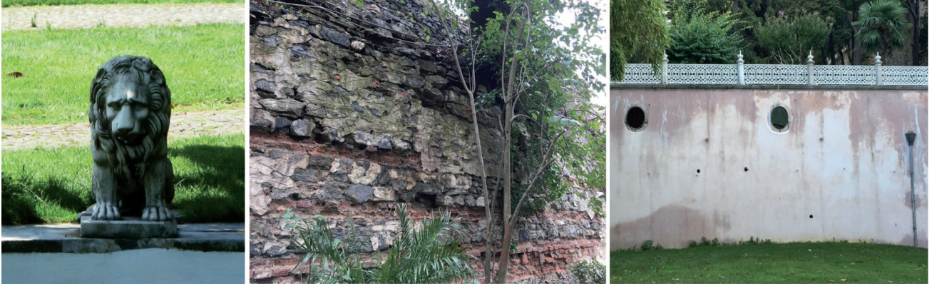
Resim 10. Solda belirli noktalarda siyah kabuk şeklinde birikimler olan Ihlamur Kasrı bahçesindeki aslan heykeli, ortada Yıldız Sarayı Şehzade Köşkleri bahçesinde yüzey sıvası ve derz harcı bozulmuş bahçe duvarları, sağda Beylerbeyi Sarayı birinci set bahçesinin duvarındaki tuz birikimleri.
