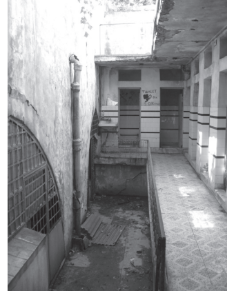
Giriş avlusu - yıkılan WC bölümü (2012)
